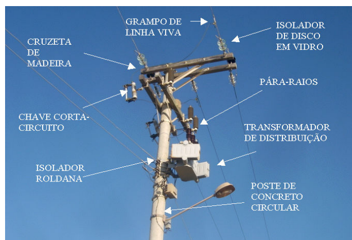
Figura 3: Componentes da rede de distribuição de energia elétrica: isoladores, cruzetas, grampo de linha viva, chaves corta-circuito, pára-raios, transformador de distribuição e poste de concreto.
