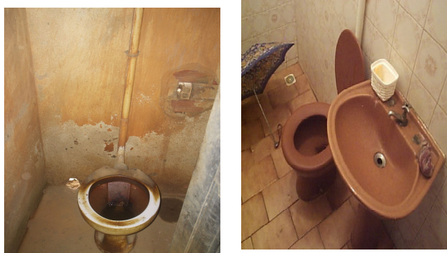
Figura 7: Banheiro dos operários. Fonte: Sebrae, 2005.
