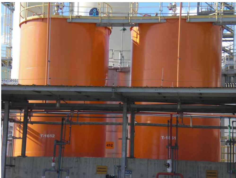
Figura 1: Tanques de Ácido Sulfúrico
