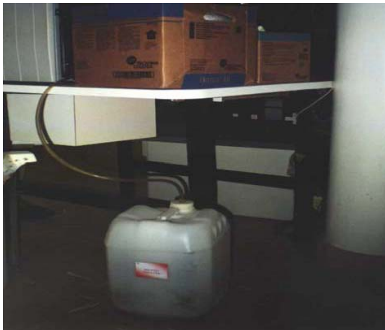
Figura 3: Coleta do “esgoto de máquina” em bombona.
