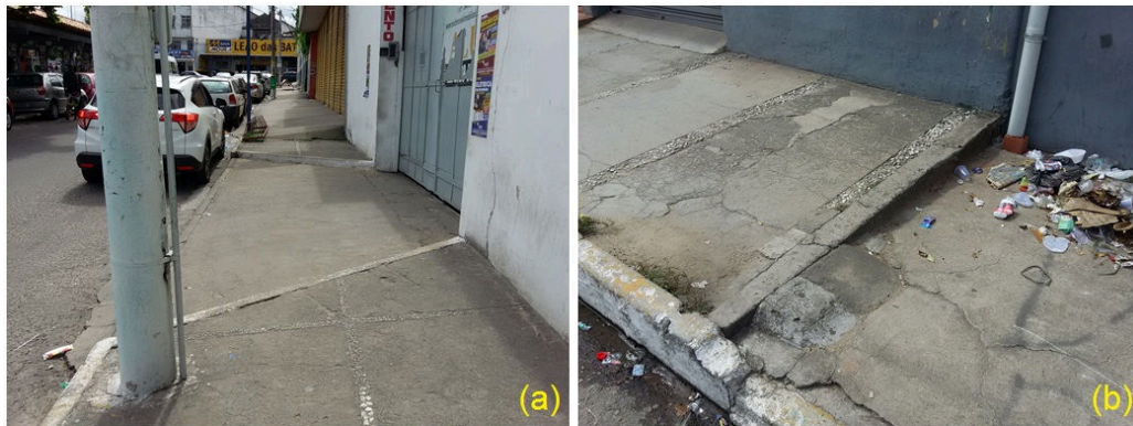
Figura 7. Degraus e desníveis acentuados na Zona Centro Histórica de Campos dos Goytacazes, RJ.
