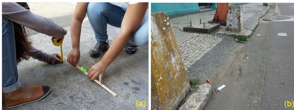
Figura 10. Medição (a) e exemplo de rampa com inclinação acima do indicado pela norma técnica (b), Zona Centro Histórica de Campos dos Goytacazes, RJ.
