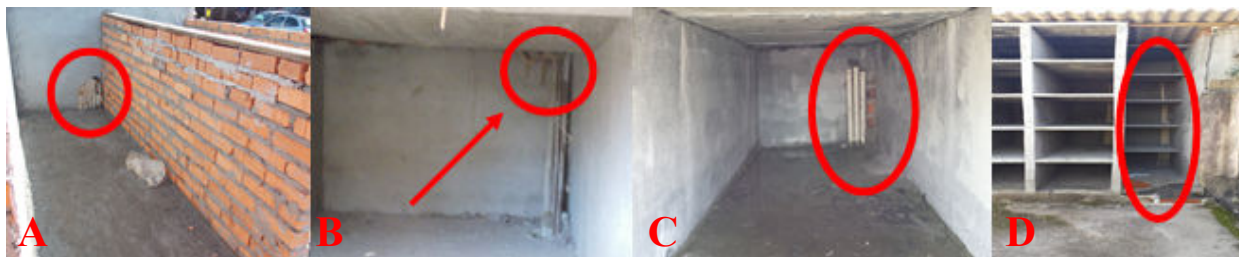
Figura 3: (A) Tubulação de recolhimento do necrochorume em jazigo em construção, (B) Tubulação de recolhimento em jazigo existente, (C) Vazamento do Necrochorume e tubulação de recolhimento advindas dos pavimentos acima situados, (D) Sistema de coleta do líquido proveniente de cada jazigo
