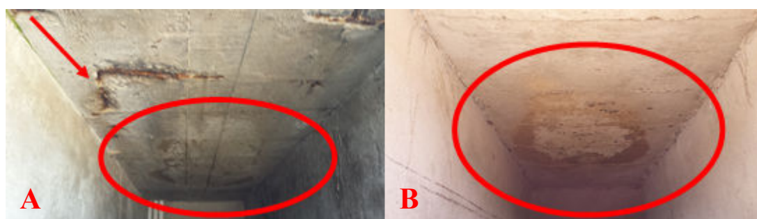
Figura 4: (A) Desgaste e infiltração na estrutura de Concreto Armado por necrochorume, (B) Infiltração
