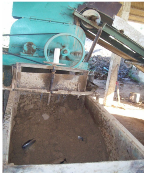
Figura 7: Corrosão em diversas partes do misturador, Cerâmica C.
