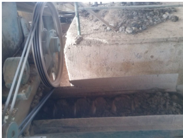
Figura 12: Misturador, Cerâmica H.
