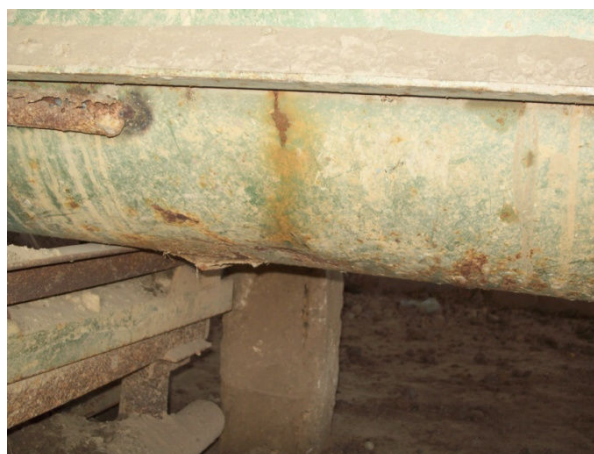
Figura 5: Corrosão no misturador, Cerâmica B.
