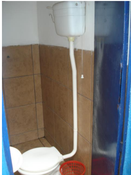
Figura 2: Vaso Sanitário com caixa do Banheiro Masculino (Térreo)
