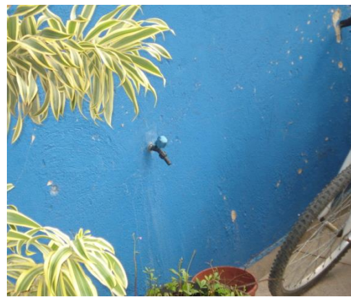
Figura 4: Torneira de Lavagem (Térreo)
